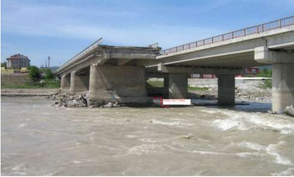
Fotoğraf 2 – Çöken Çaycuma Köprüsü
