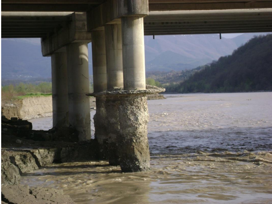
Resim – 1. Filyos II Köprüsü Ortaayaklarının Tabandaki Oyulma Sonrası Durumu
